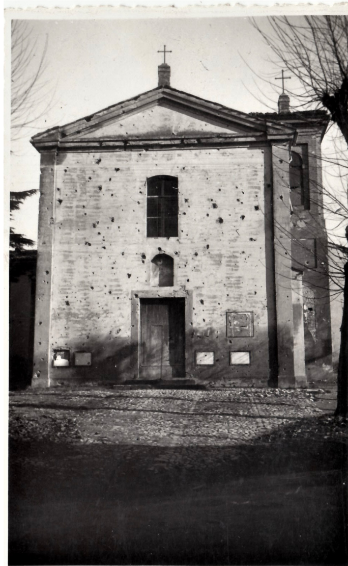
FIG. 7 La chiesa subito dopo la Seconda guerra mondiale: si vedono ancora sulla facciata i colpi di mitragliatrice
